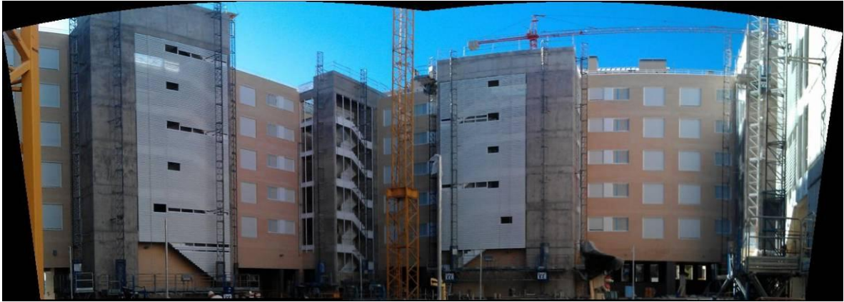
VISTA GENERAL DE FACHADA INTERIOR DE LA PARCELA (ESTRUCTURA Y LAMAS DE ESCALERAS DE PORTALES 1, 2 Y 3)
