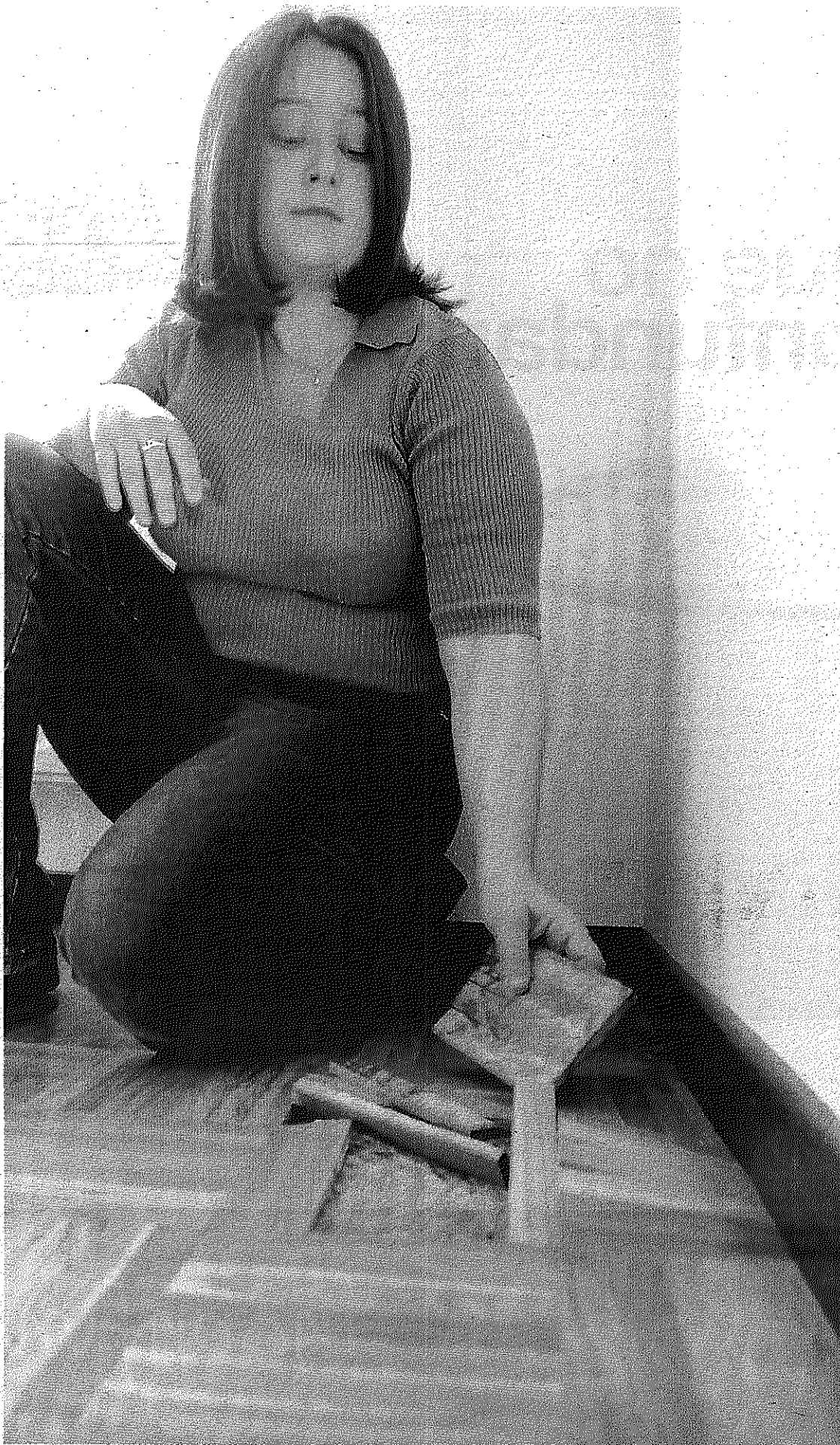
Una mujer observa las deficiencias de una vivienda de nueva construcción/LV
