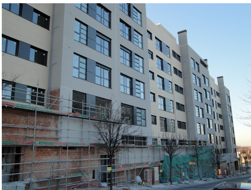
FACHADA ALZADO NOROESTE
