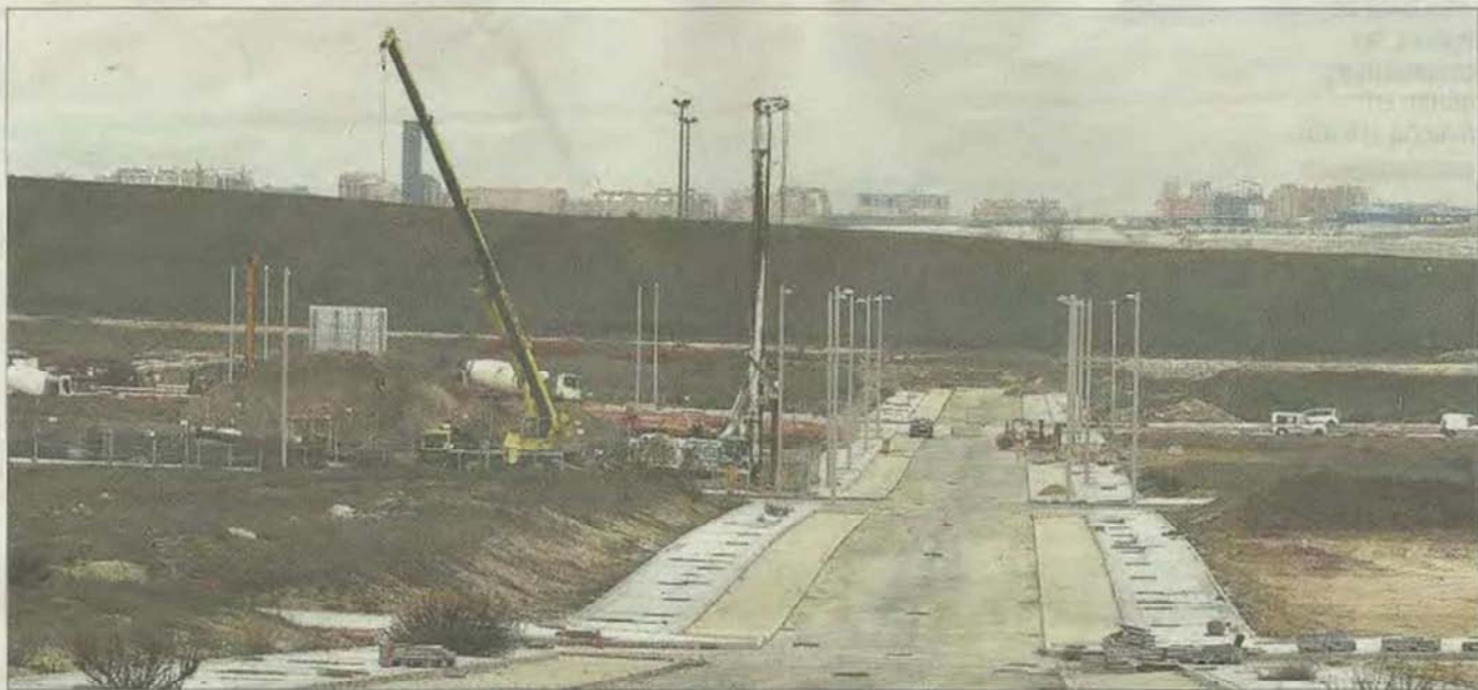
Obras de vaciado y cimentación de una de las promociones que acaban de iniciarse en el PAU de El Cañaveral, al sureste de Madrid. / PACO TOLEDO
