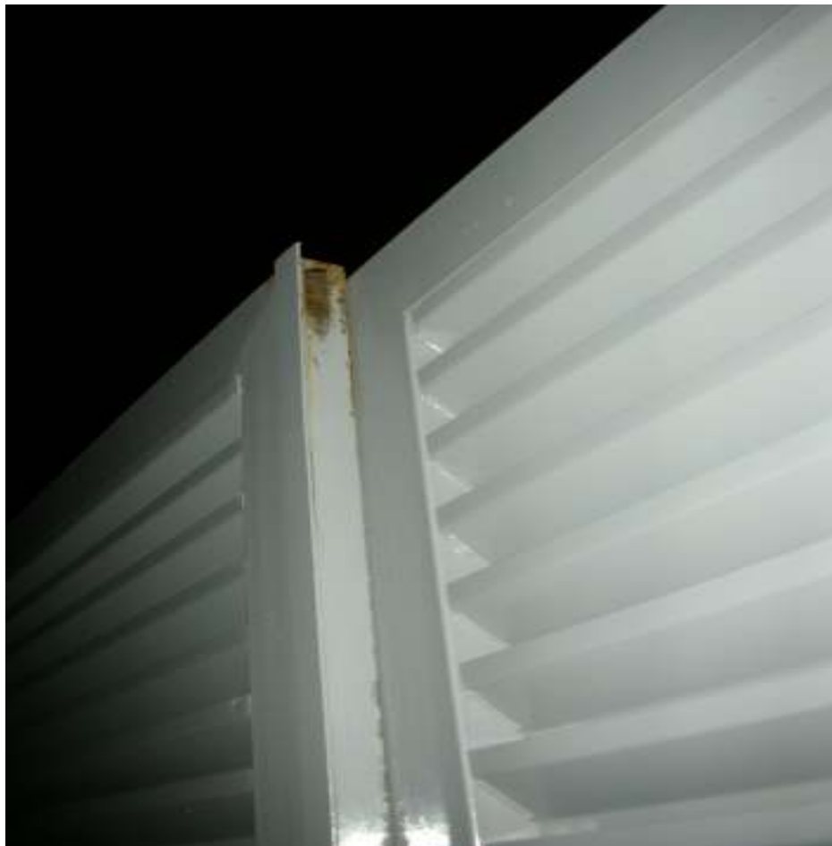
... lo que ha provocado que la puerta se haya descolgado totalmente
