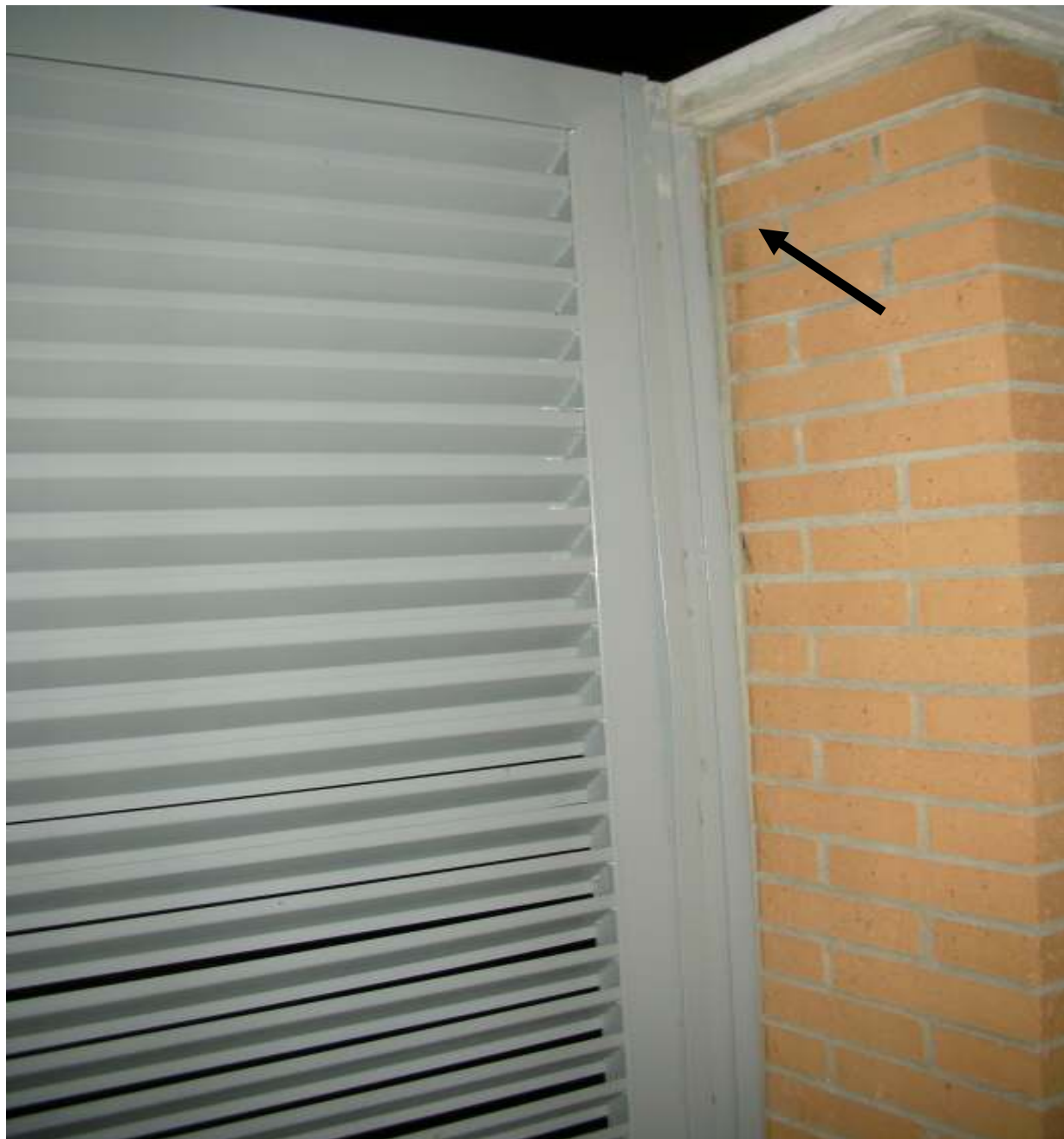
Se observa que el marco de la puerta se ha separado del muro de ladrillo
