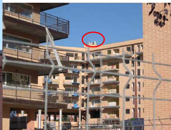
Vista de Máquina A/A encima de Casetón del ascensor. Vista Interior
