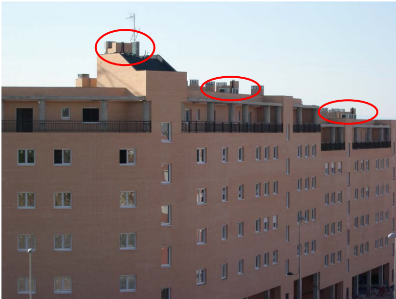
Vistas de Máquinas A/A en la azotea en la C/Presidente Adolfo Suárez. Vista desde la Perlita
