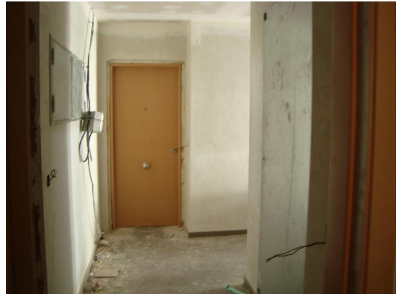
ASPECTO GENERAL DISTRIBUIDOR DE PLANTA
