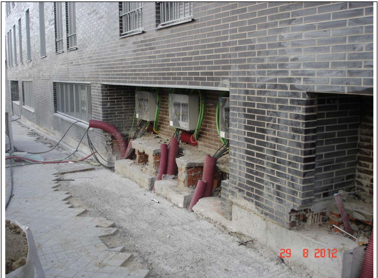
Acometidas de electricidad.
