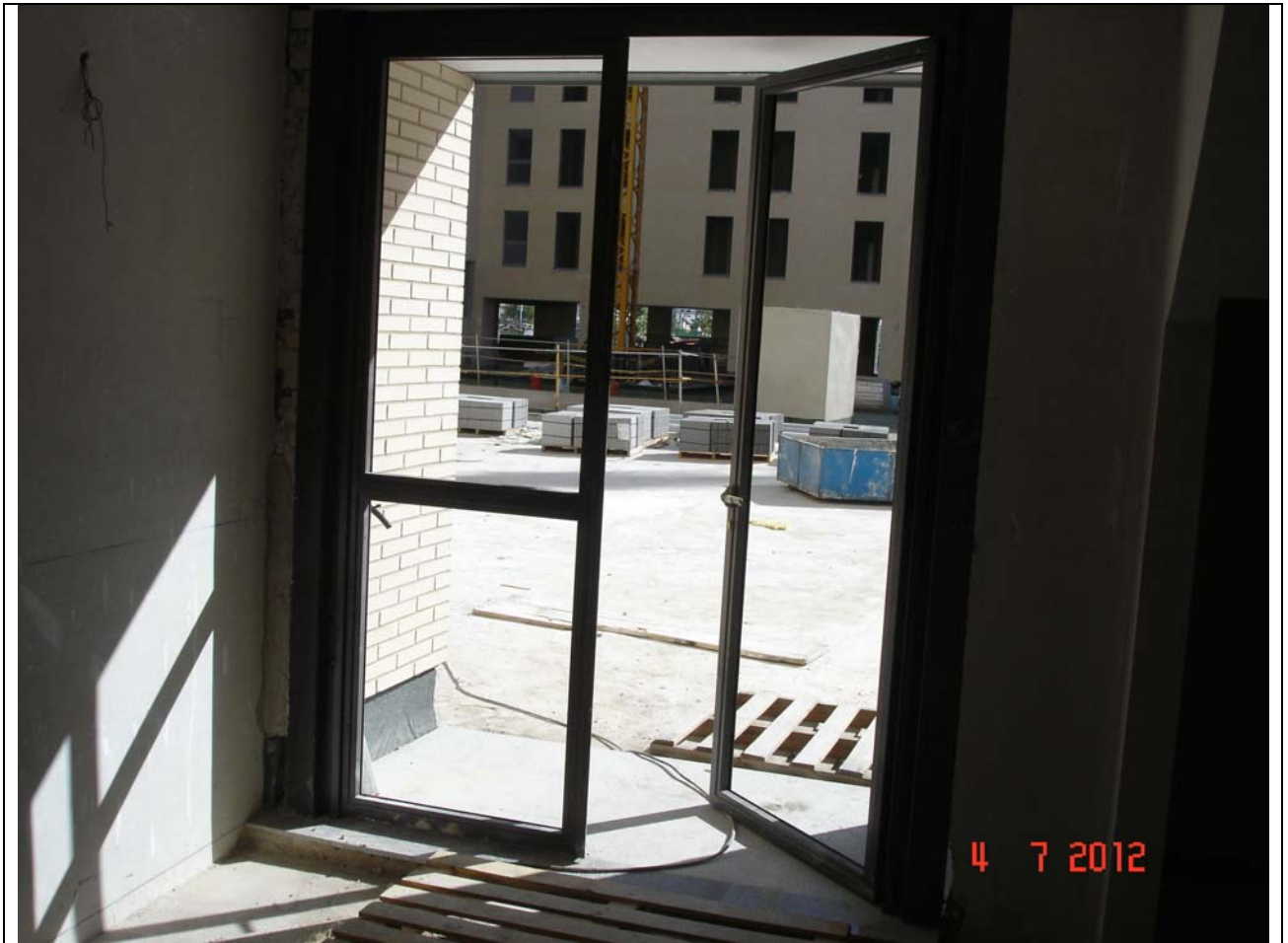
Cerrajería en puertas de portal..
