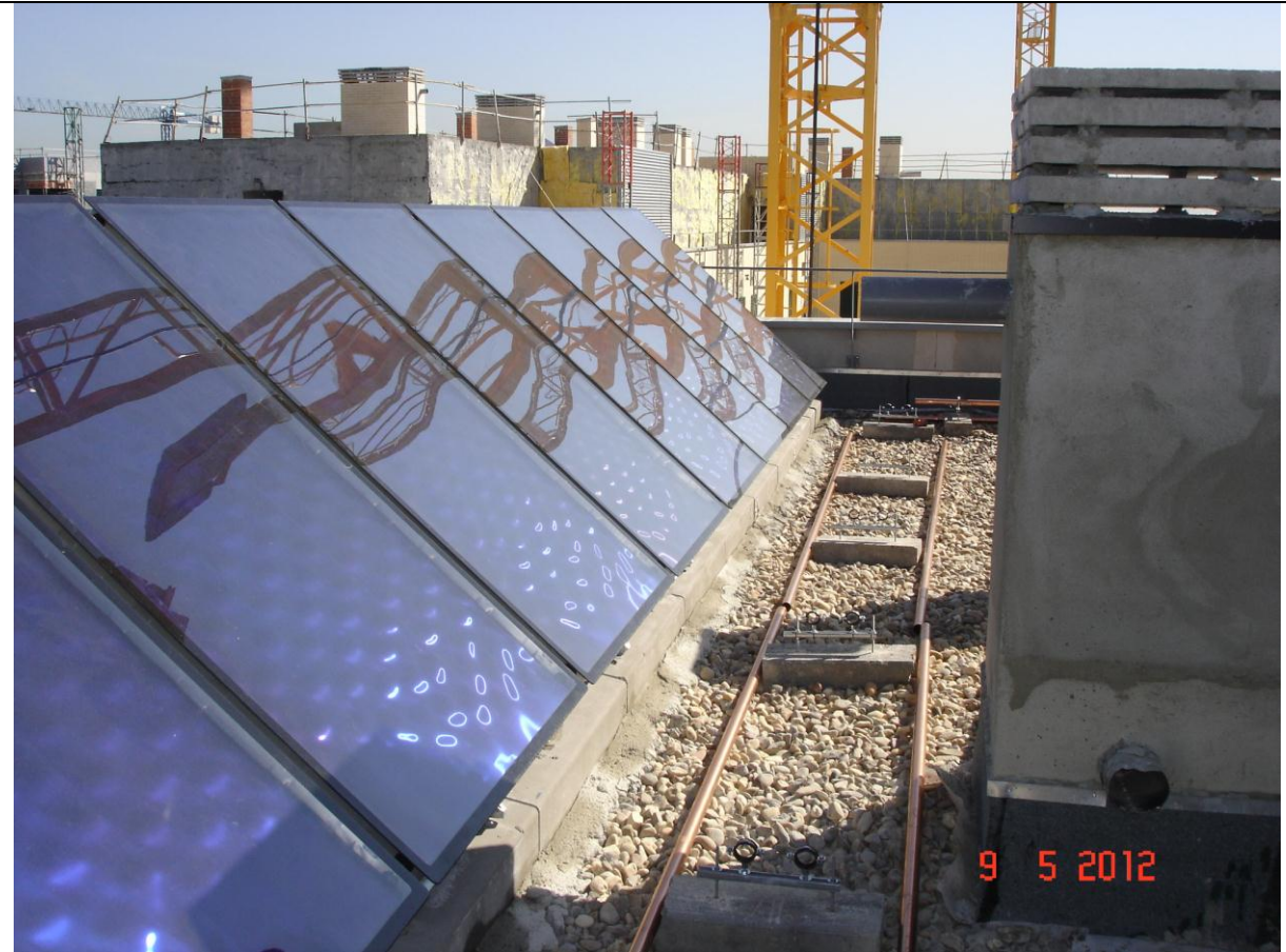
Cubierta, paneles solares..
