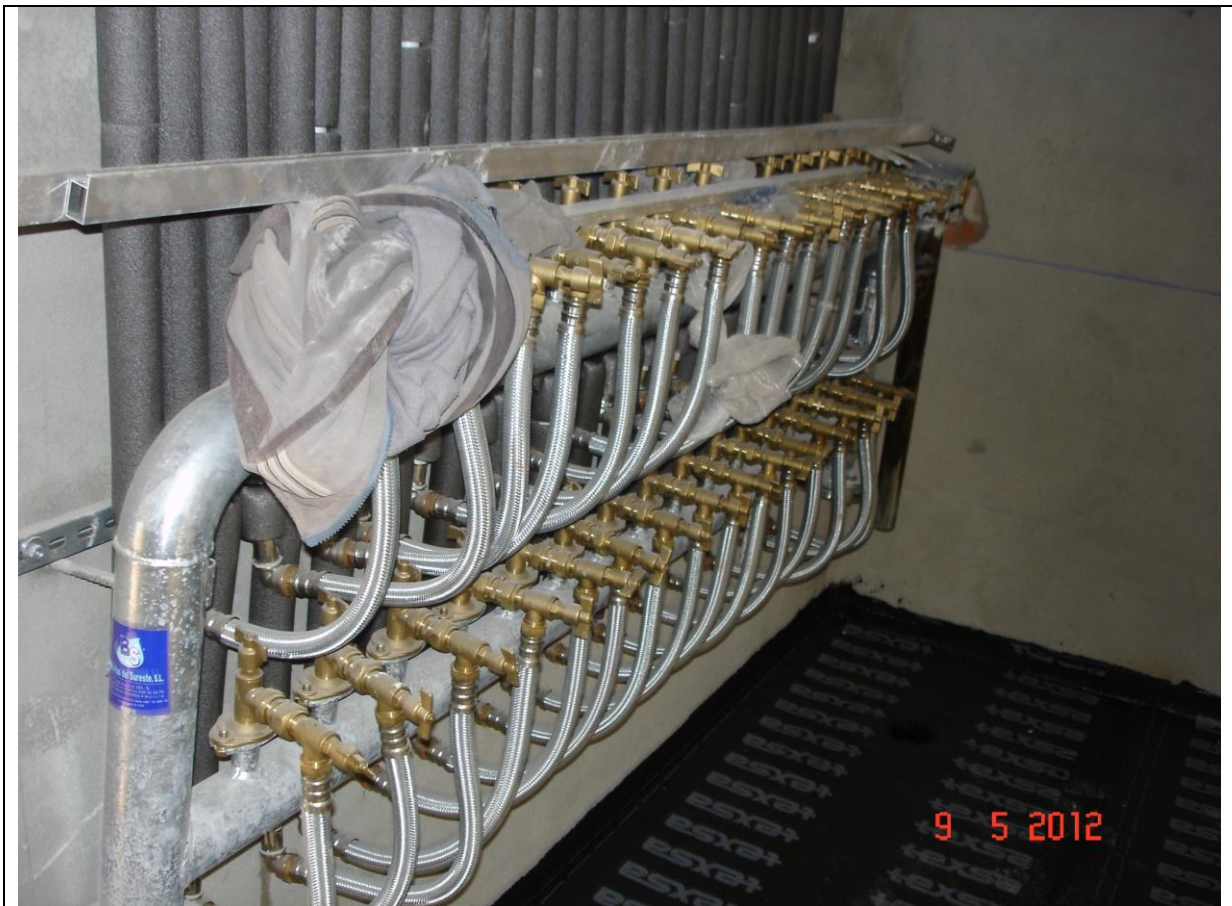
Fontanería, batería contadores agua.
