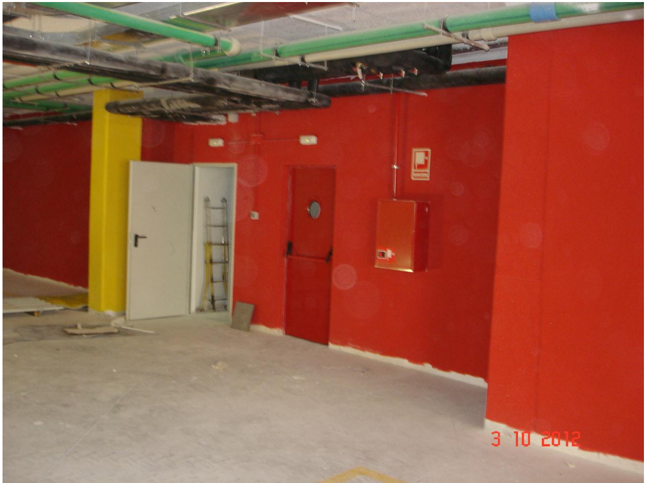
Vista interior garaje, detalle de pintura sótano primero.
