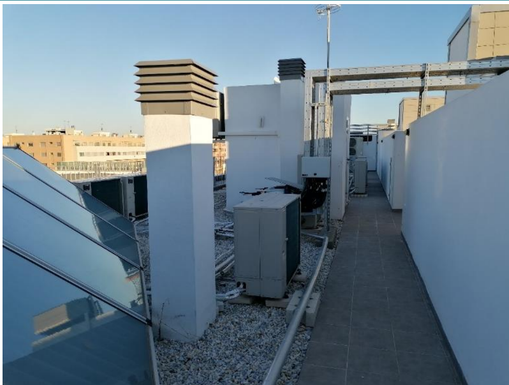
Placas solares con sombras generadas por muro terrazas privativas
