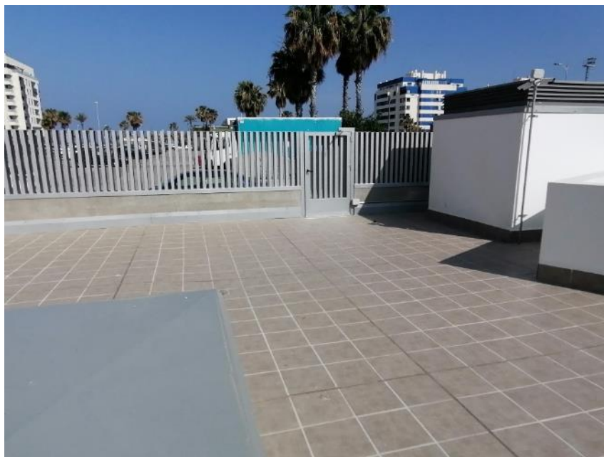
Entrada exterior al recinto sin iluminación
