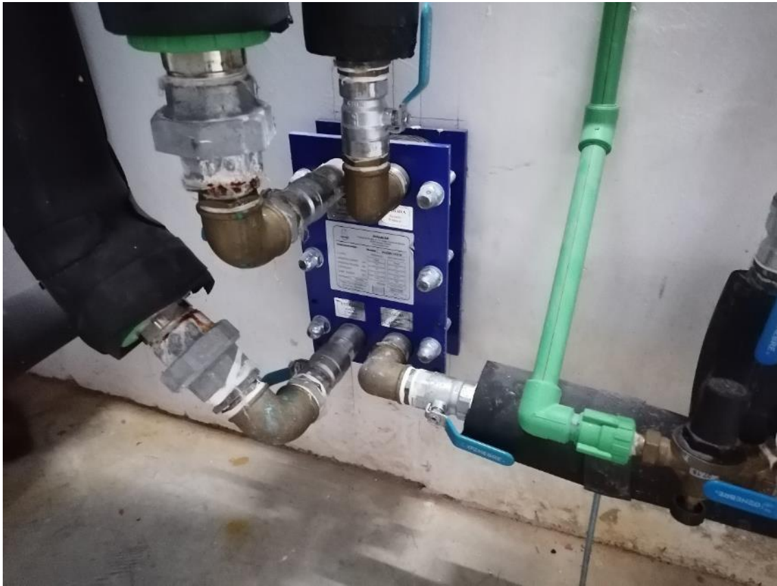
Intercambiador primario-secundario y aporte agua en circuito primario
