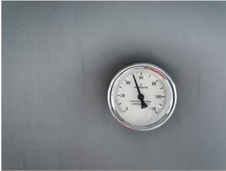
Termómetro depósito acumulador acs solar
