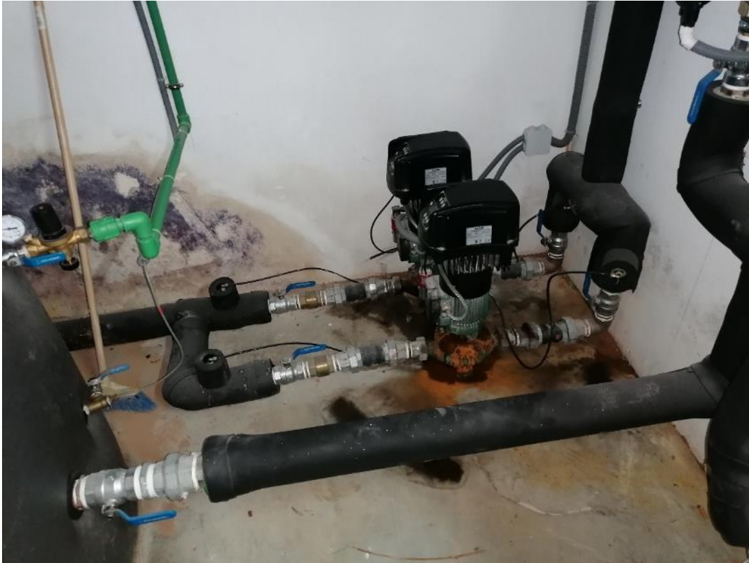
Bombas circuito terciario con restos de escape de aceite y humedad escape de agua depósito
