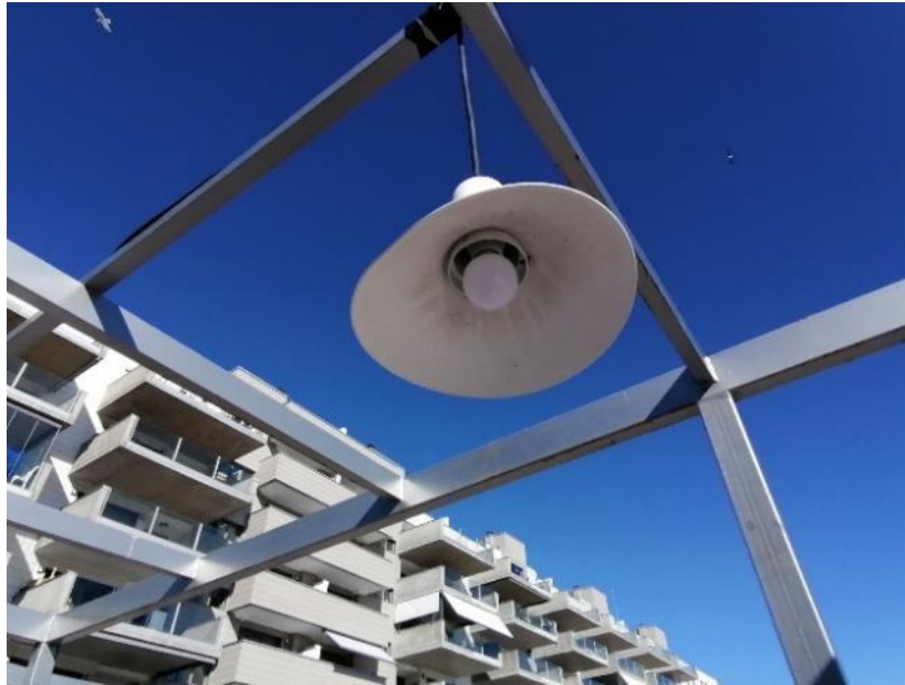
Pantallas instaladas en zona pérgolas
