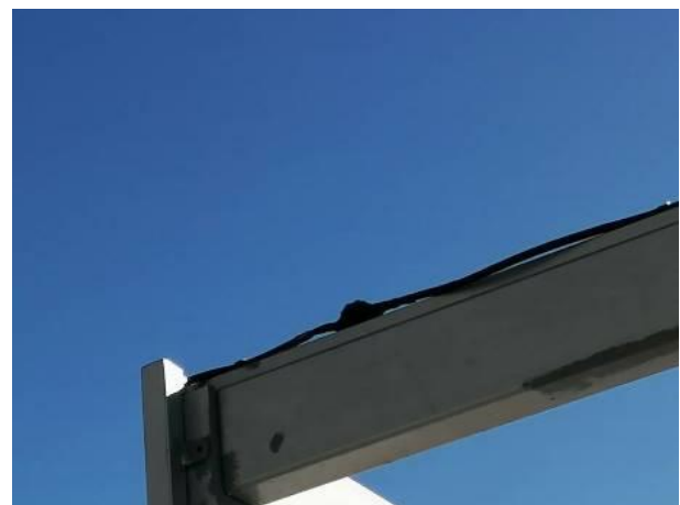
Conexión de cables fuera de caja de derivación
