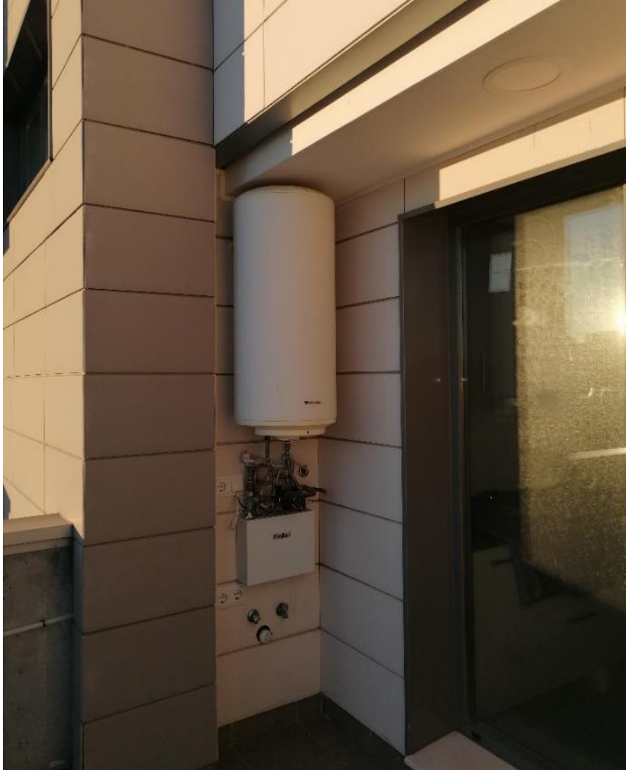
Termoacumulador eléctrico, intercambiador y bomba circuladora instalados en terraza de vivienda
