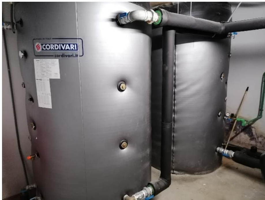
Depósitos acumuladores acs solar
