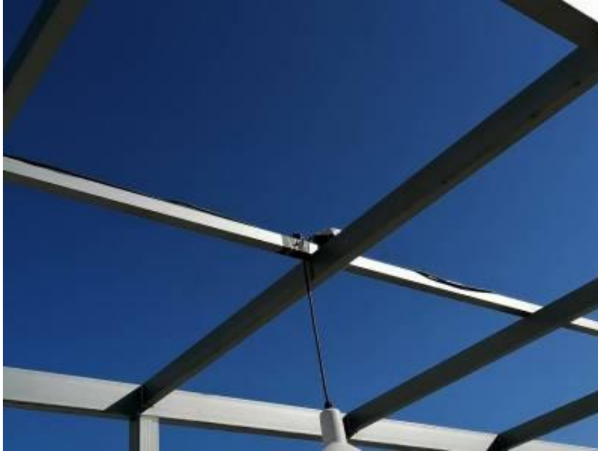
Pantalla colgada de cable en zona de pérgolas
