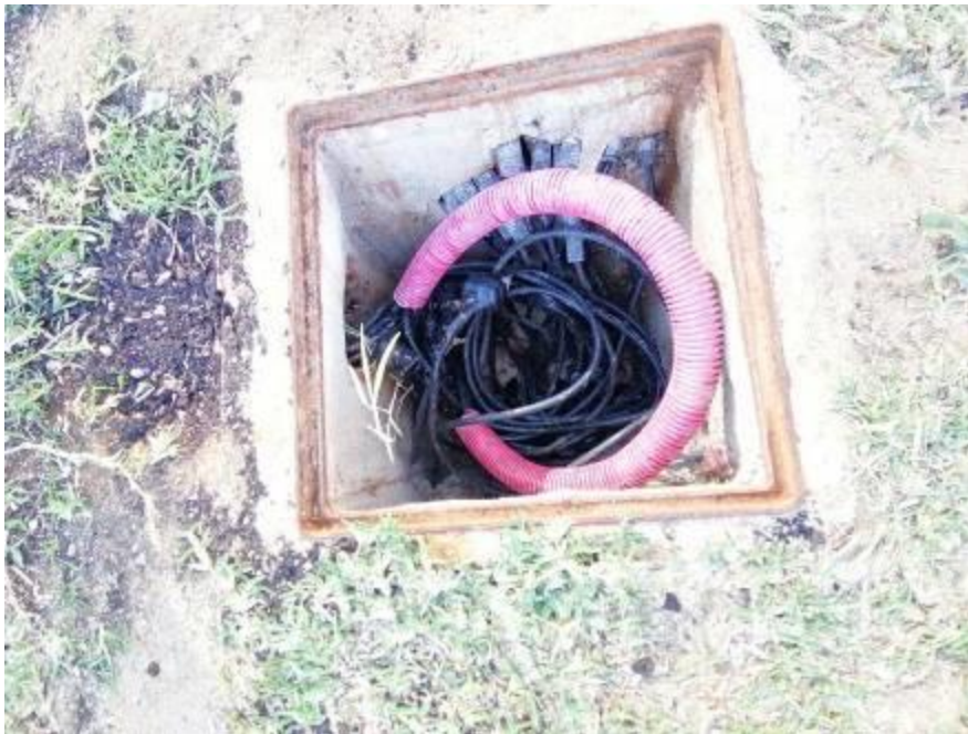
Conexiones de cableado en interior de arqueta
