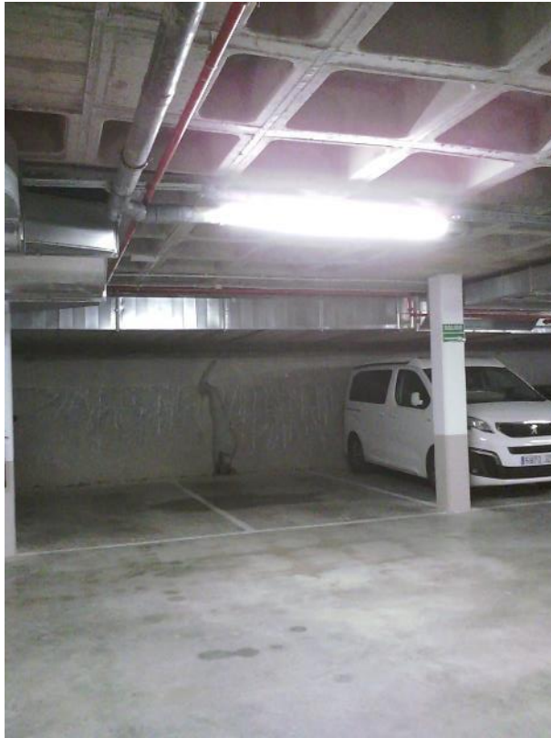
Acumulación de agua en la plaza 11 procedente del sumidero 4
