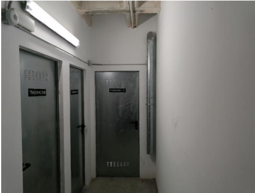
Conducto aportación de aire en pasillo trasteros planta sótano
