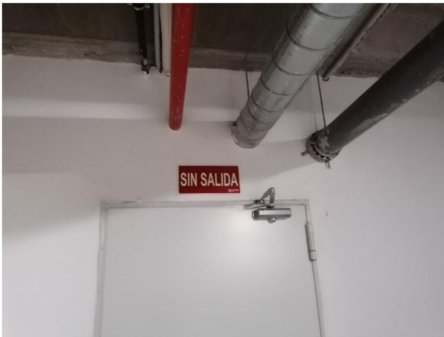
Conducto de paso entre garaje y trasteros sin compuerta cortafuego
