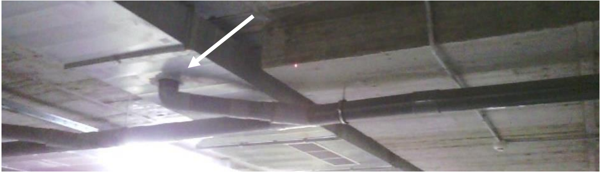
Conducto de pluviales atravesando un conducto de ventilación
