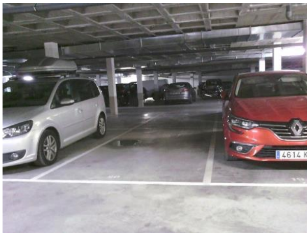
Agua acumulada en la plaza 20. Bajo sumidero X
