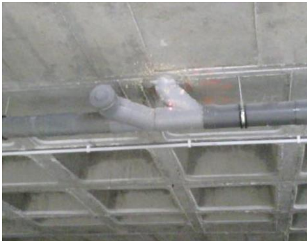
Conexión X no correspondiente con un sumidero en cubierta
