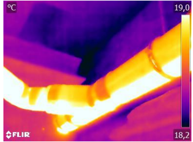
Humedad en techo
