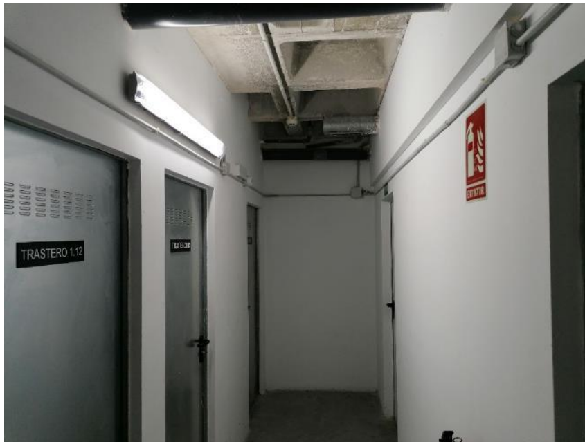
Rejilla extracción en techo pasillo trasteros planta sótano
