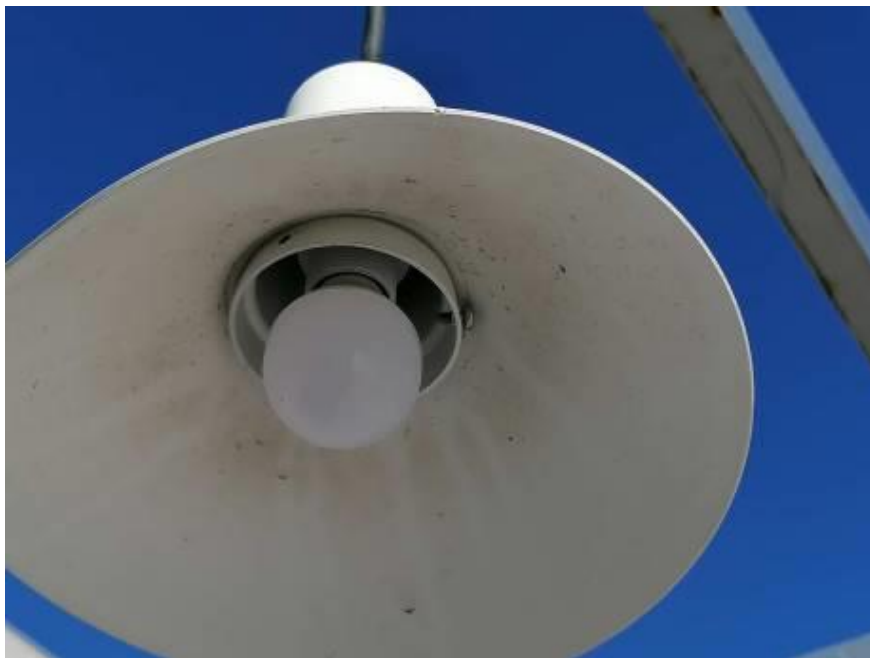
Falta de estanqueidad en pantallas ubicadas en pérgolas
