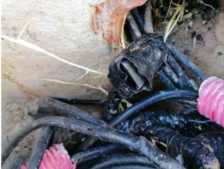
Conexiones en arqueta con falta de aislamiento
