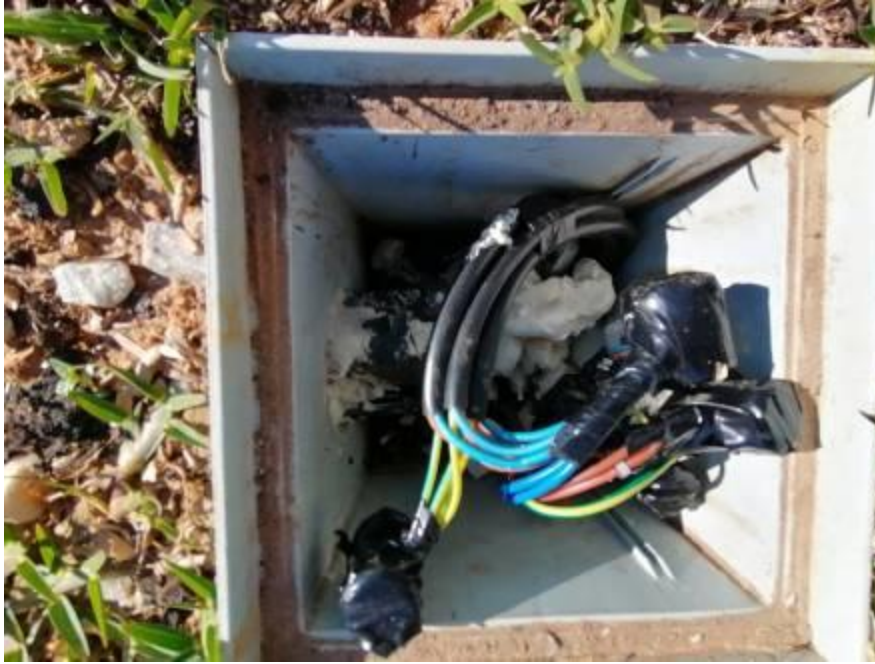
Conexiones de cableado en interior de arqueta
