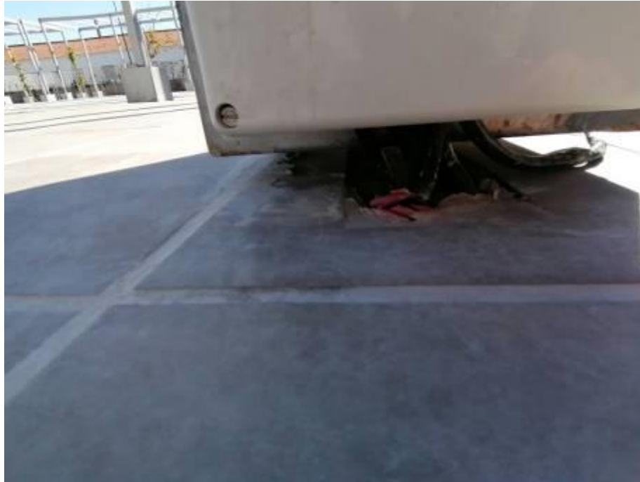
Canalización eléctrica sin sellar
