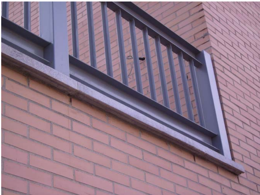
Fotografía n.º 6. Deficiencias en remates.
