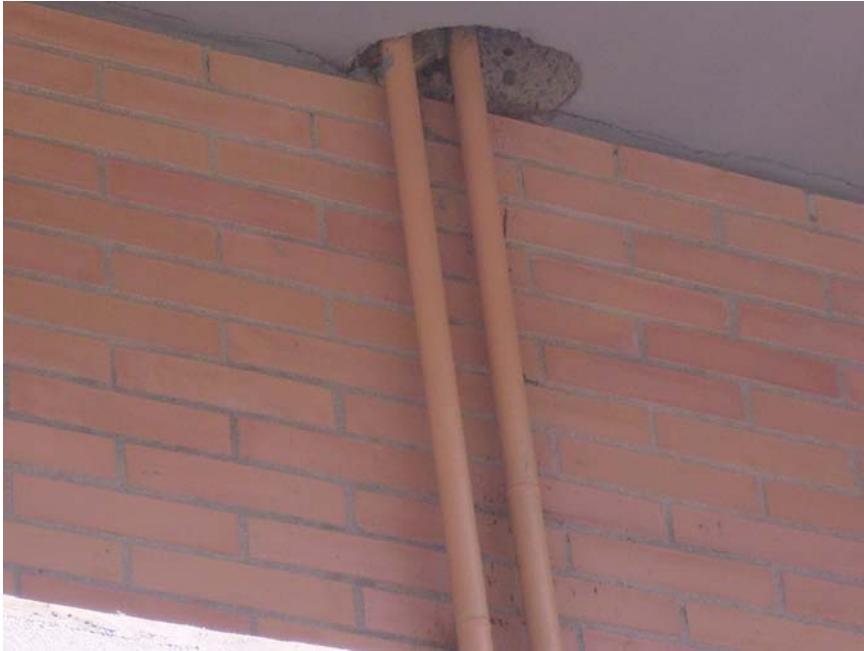
Fotografía n.º 14. Huecos sin sellar. No se ha dispuesto pasatubos de forjado.
