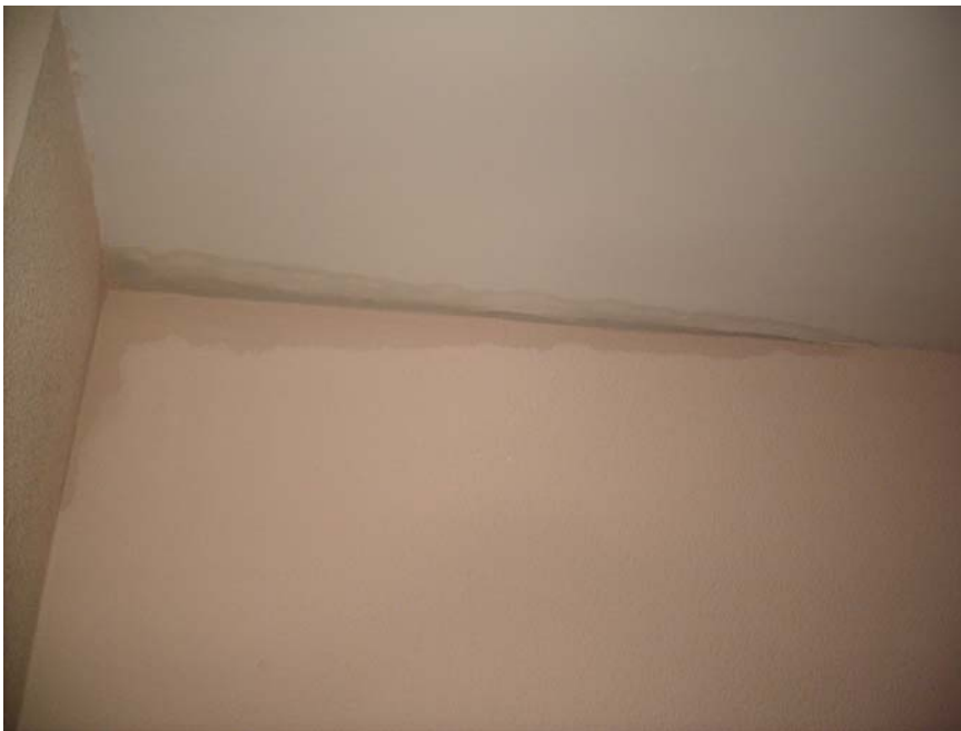
Fotografía n.º 10. Humedad en techo, en portal 4, tramo a sótano.
