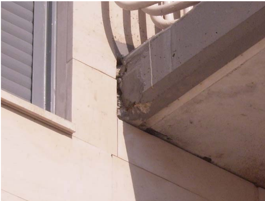
Fotografía n.º 8. Deficiencias en remates de encuentros.
