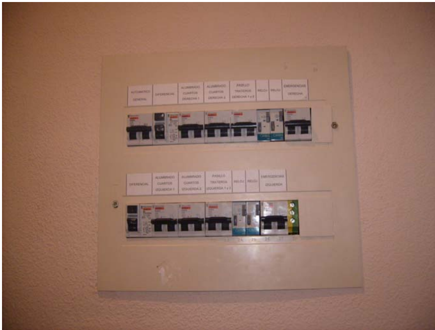
Fotografía n.º 11. Cuadro de electricidad sin tapa de protección, y deficientemente atornillado.
