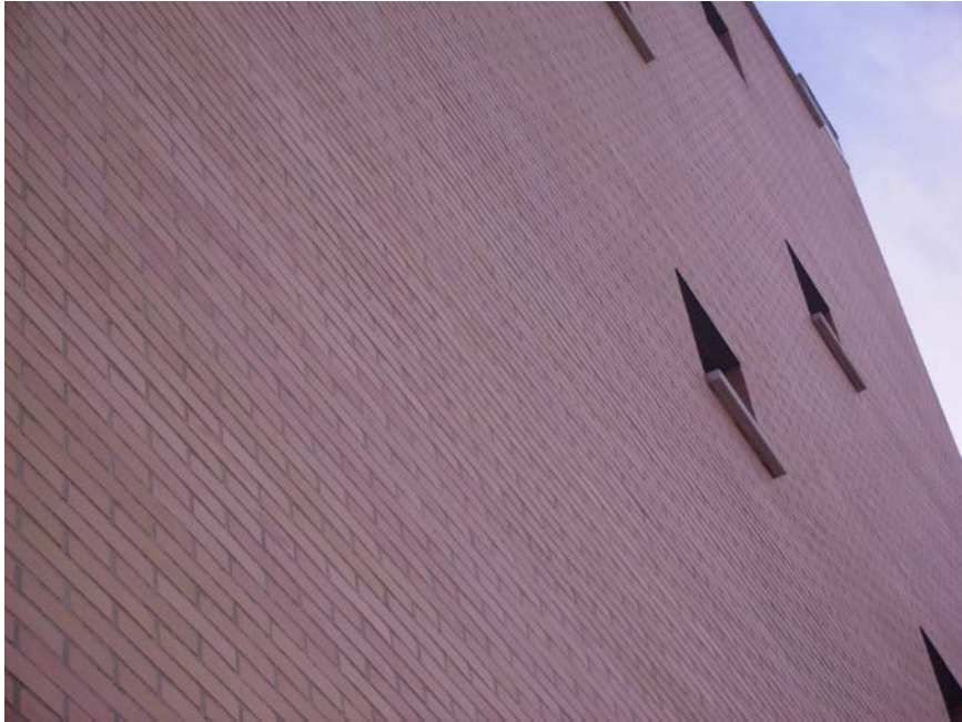
Fotografía n.º 5. Deficiencias en remates de juntas con alféizares.
