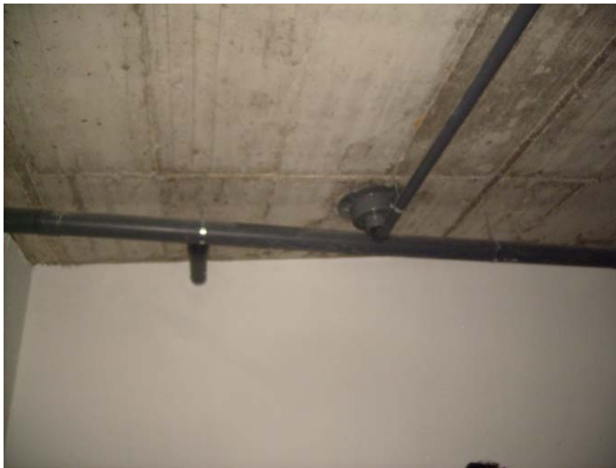
Fotografía n.º 12. Filtraciones de agua en proximidad a sumidero y red de desagües.
