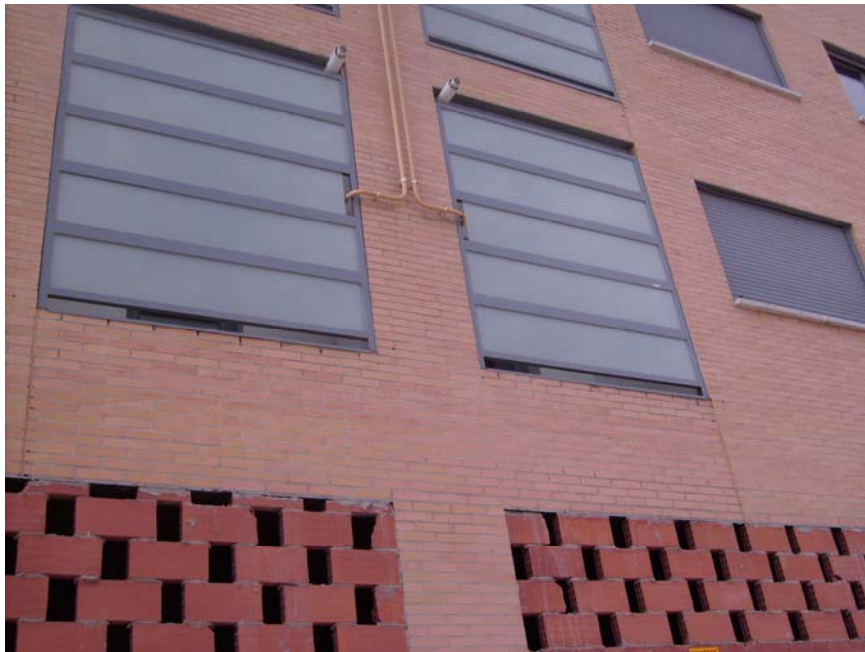
Fotografía n.º 2. Puntualmente se advierte falta de ladrillo visto en fachada y generalizadamente defectos en llagas y tendeles de ladrillo visto.
