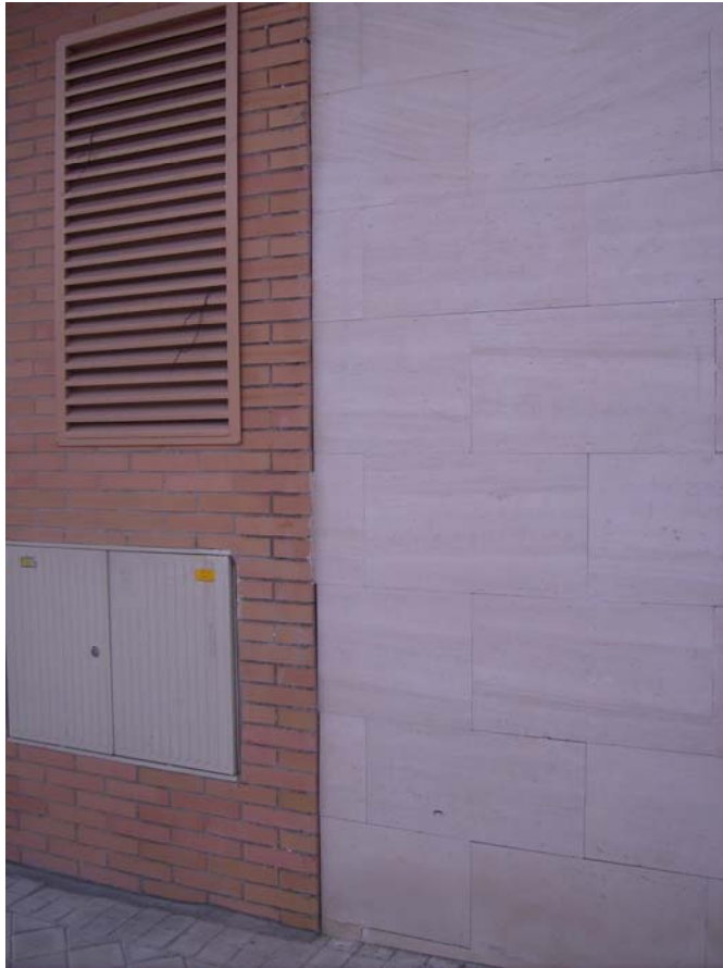
Fotografía n.º 3. Plaqueta juntada a “hueso”, si lechada de remate entre cantos de aplacado visto En este caso, obsérvese además junta entre ladrillo y plaqueta no finalizada.
