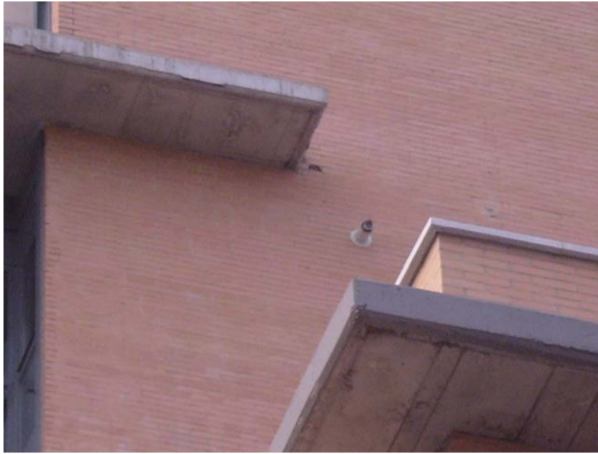
Fotografía n.º 1. Remate deficiente de marquesinas de hormigón hidrófugo.
