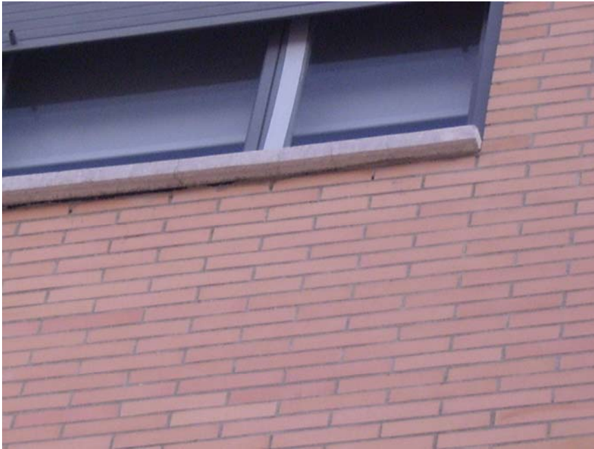
Fotografía n.º 7. Deficiencias en remates.
