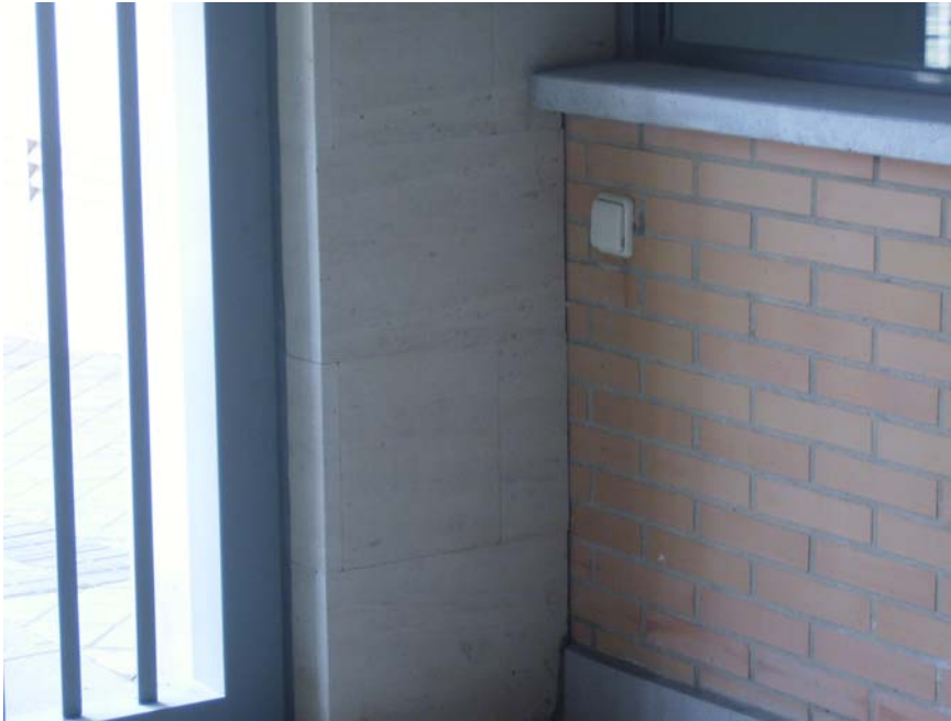
Fotografía n.º 9. Pulsador de apertura de puerta con facilidad excesiva de manipulación desde el exterior.
