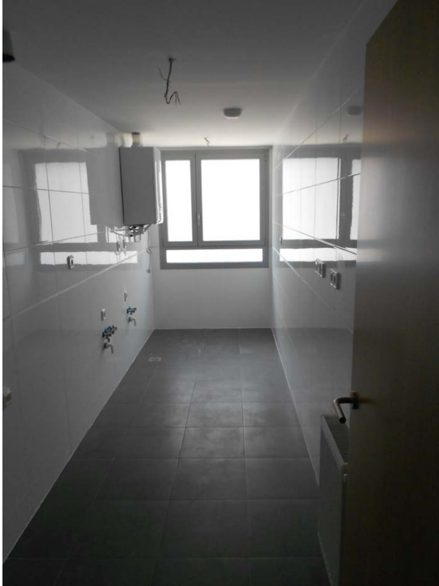
VISTA DE COCINA DE VIVIENDA
